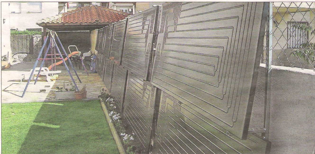
Varios paneles termodinámicos colocados en el jardín de una vivienda. / EL MUNDO
