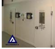
Cámaras de estabilidad
